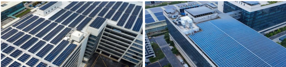
东莞洪梅达瑞电子1.49MWp屋顶分布式光伏项目
