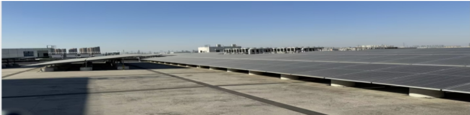
苏州工厂分布式屋顶光伏电站
