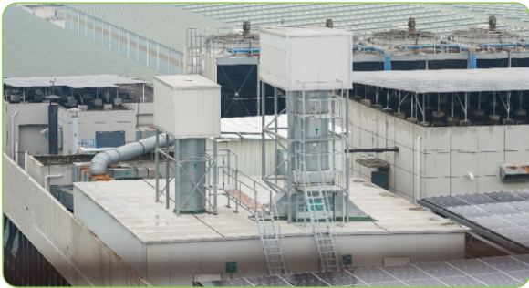
东莞达瑞厂房楼宇顶层活性炭废气处理设备
